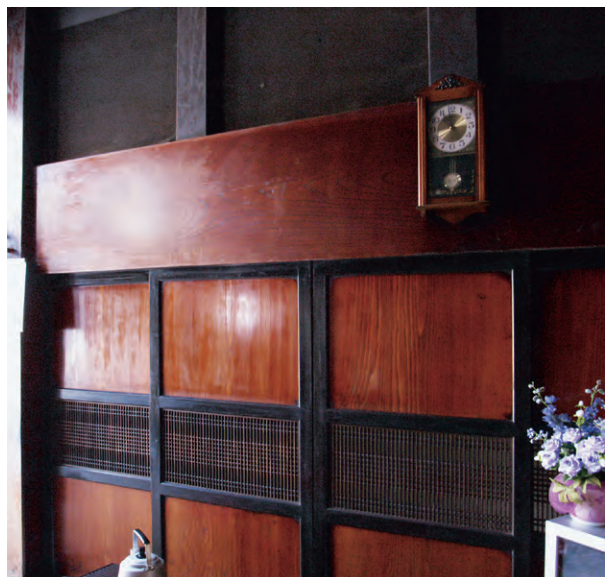
100年の時を経て地震に遭っても、無傷で輝きを放つ差し鴨居や建具
