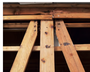
筋交いも面材も、釘留めされた部材は、一度緩むと元に戻らない
